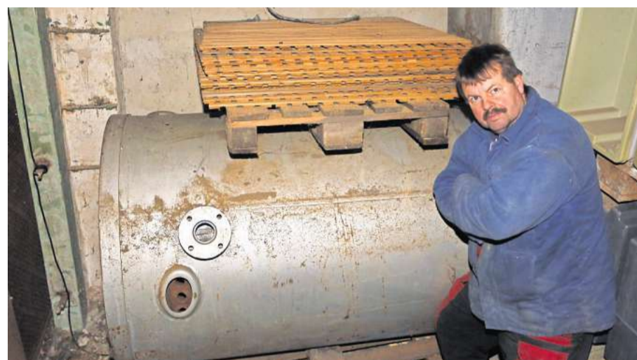
Lutz Bunge vor dem Dampfkessel aus dem Jahr 1989, dessen Nutzung das Leipziger Umweltamt untersagt.
